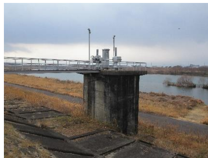
桑原揚水機場(水門)
